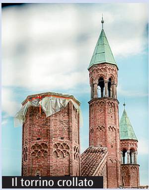
Il torrino crollato
